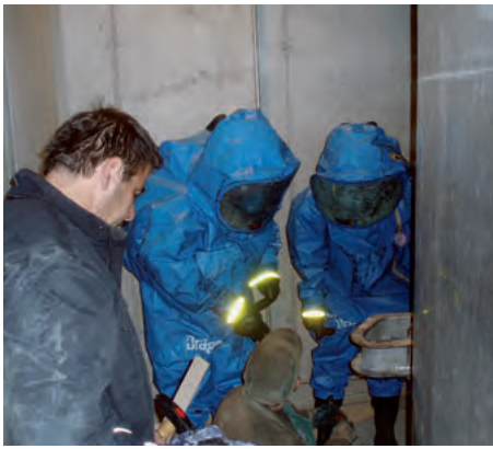
20. und 21.10. Abdichten eines Mannlochdeckels des Peroxidtanks in der Deinkinganlage, Einsatz mit Vollschutzanzügen, Wechsel der Deckeldichtung.
